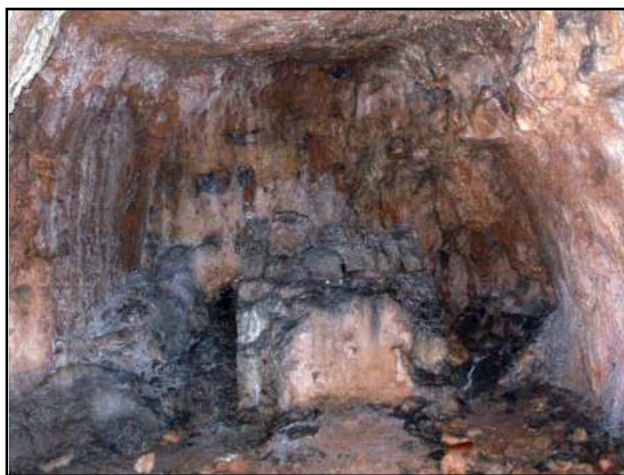
Fig. 9 : La chapelle est, plongée dans l'obscurité totale. L'autel en moellon est en piètre état.
